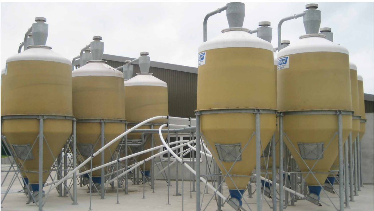
Die Siloanlage vor dem Maststall des Lehr- und Versuchszentrum Futterkamp.
