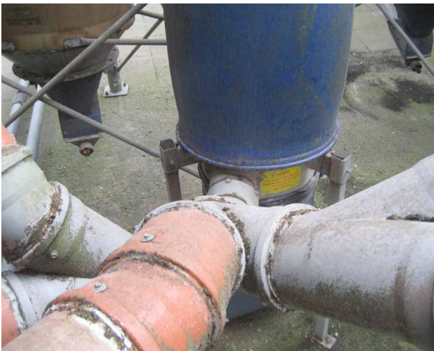
Auf diesem Bild sind 5 Futtersilos an einem Staubzyklon angesetzt.
