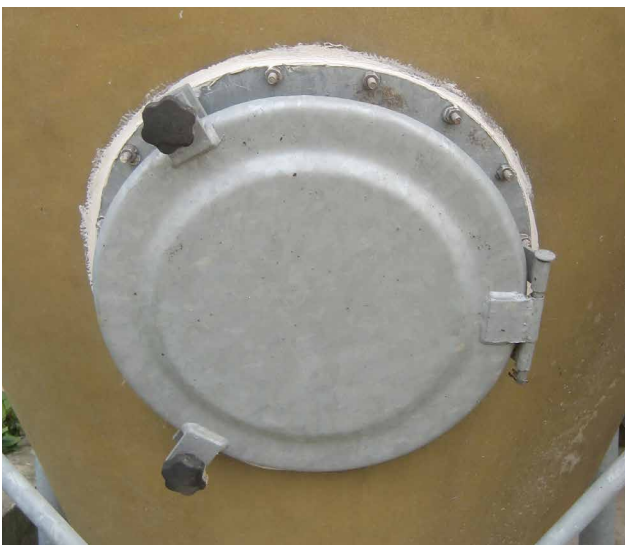
Eine im Nachgang eingesetzte Serviceklappe.
