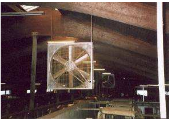
Nachträglicher Einbau von Ventilatoren im Laufstall- teilweise auch über dem Melkstand – Positiv für die Kühe. Foto: Anna Maria Miller
