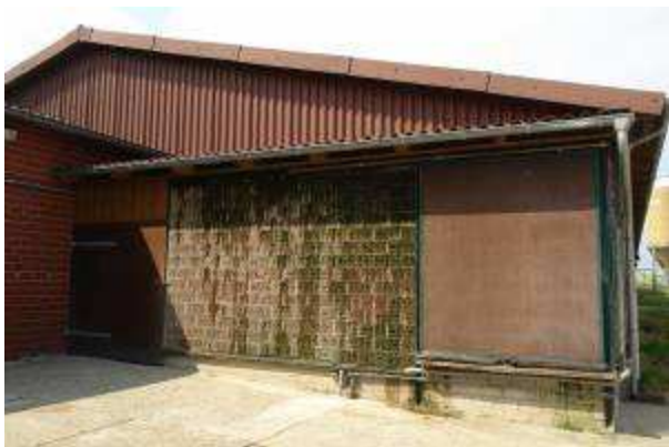
Abb. 1: Wasserberieselte Porotonsteine als Luftkühlung. Foto: M. Weber
